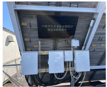
傾斜面裏には蓄電ボックスが
