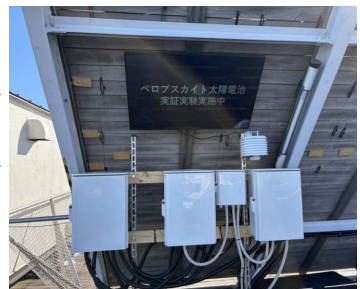
傾斜面裏には蓄電ボックスが
