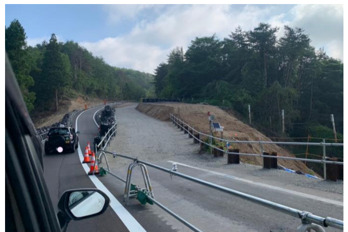
谷側が崩落し片側通行ののと里山海道
